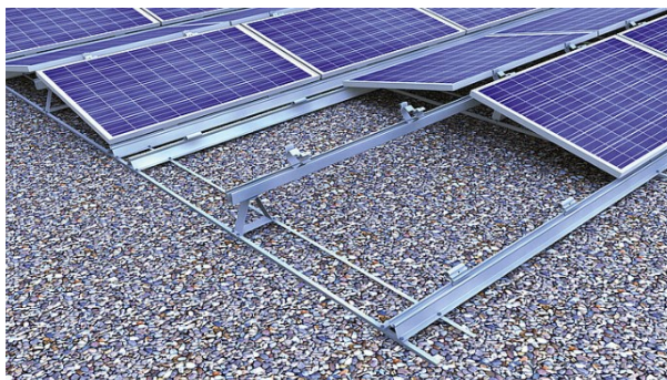
Abb. 8: Kiesdach mit PV-Elementen
